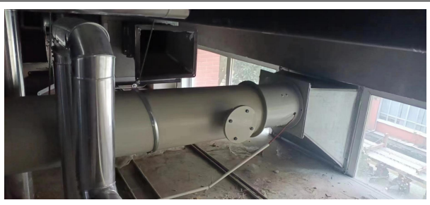
图4-7 3#排气筒（危废仓库）
