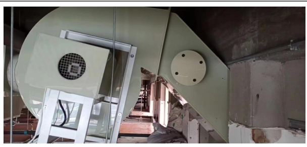
图4-5 2#排气筒（QC处理间2、仪器室2、仪器室3、仪器室4）
